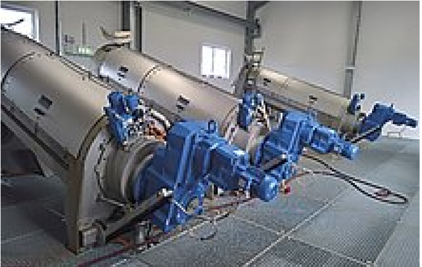
Tre presse a coclea Q-PRESS di HUBER (2 unità Q-PRESS 620 disidratano i fanghi in eccesso e 1 Q-PRESS disidrata i fanghi residui da flottazione)
