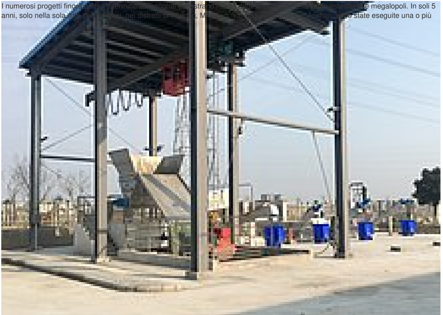
Impianti di trattamento sabbie di HUBER nella città cinese di Kunshan
