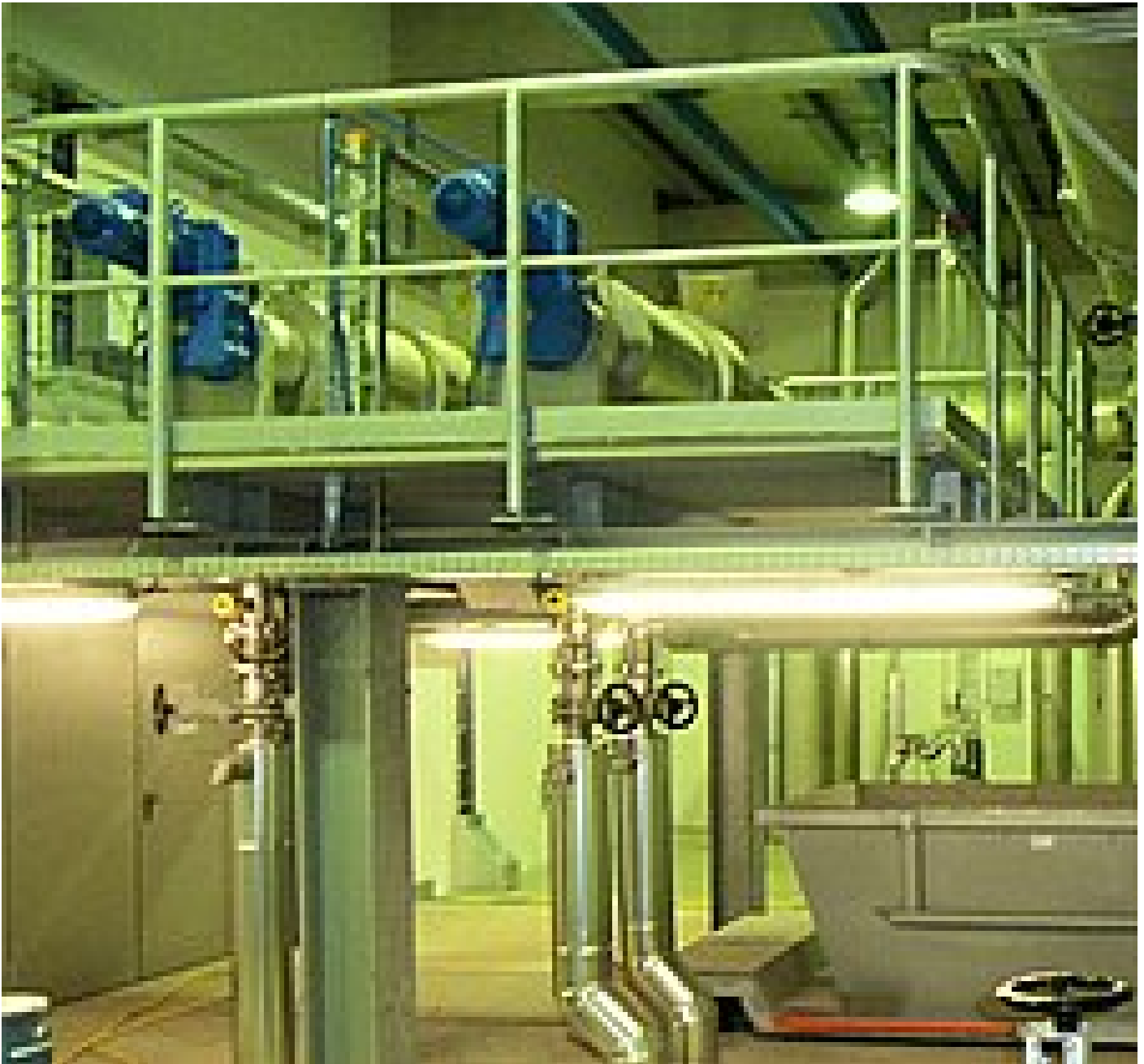
Deux machines STRAINPRESS® isolées pour le tamisage des boues grasses, dont un conteneur de déchets pour les déchets de tamisage
