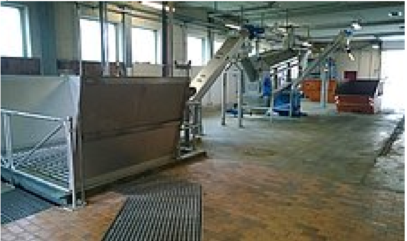
Procédé de réception des sables RoSF5 VW dans la station d'épuration de Coblenche
