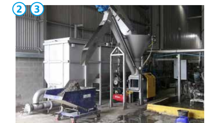
HUBER Langsandfang ROTAMAT® Ro6 Bio und HUBER Sandwaschanlage RoSF G4E Bio.
