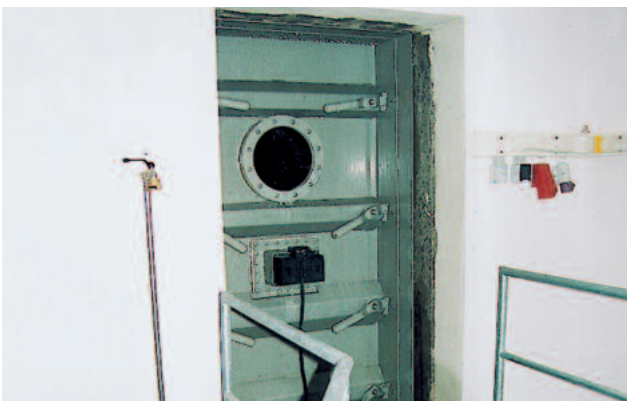
Porte étanche TT 7 avec hublot d'inspection et éclairage
