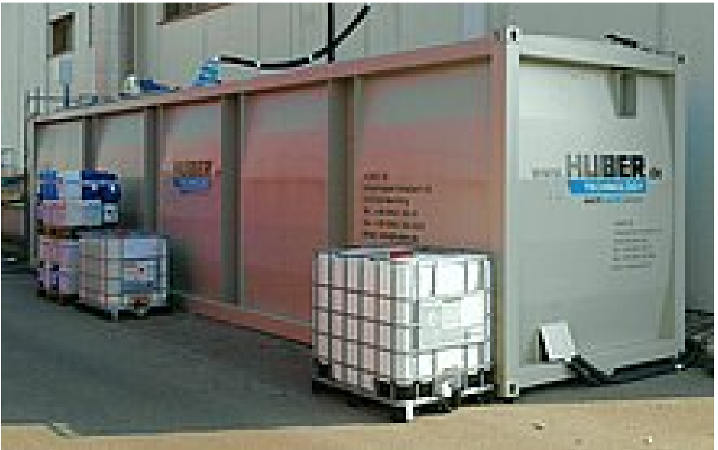
Versuchsanlage in Container-Bauweise
