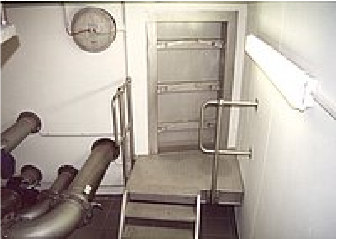
Optimal gestalteter Zugang mit einer HUBER Drucktür zu einer Wasserkammer in einem Trinkwasserspeicher
