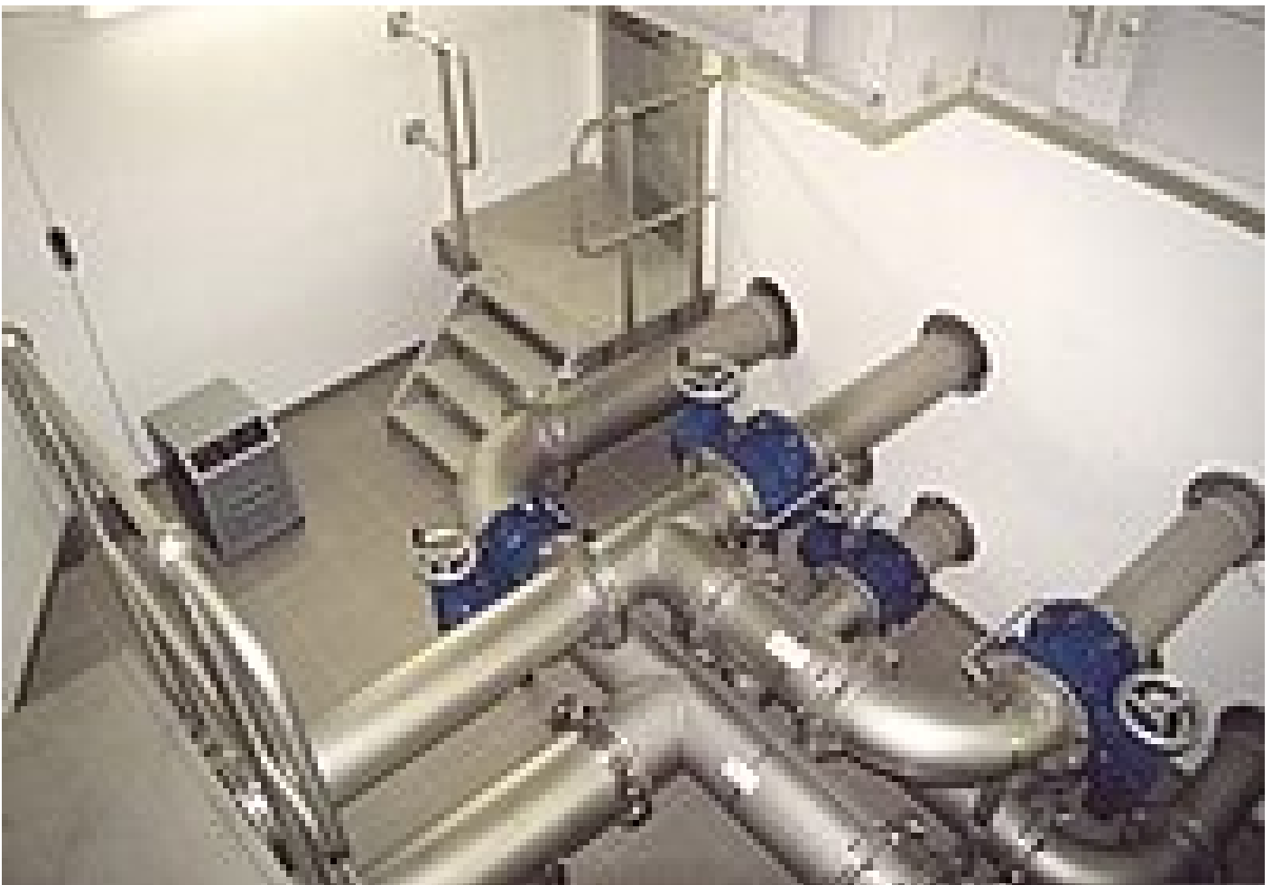
Funktionssichere und optisch ansprechende, hygienisch saubere Rohrleitung
