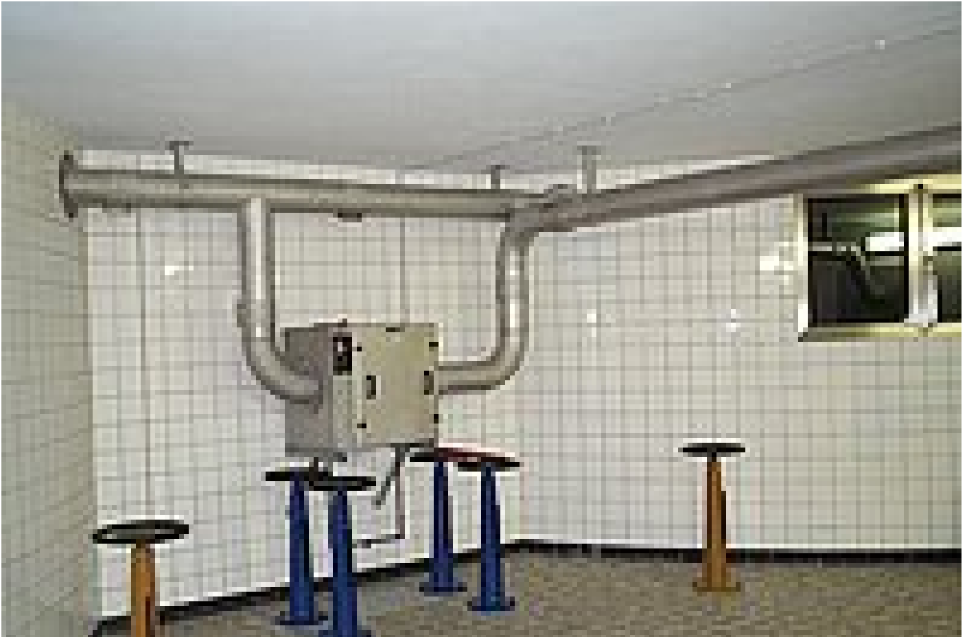
Nachträglich in den Trinkwasserspeicher eingebaute HUBER Luftfilteranlage
