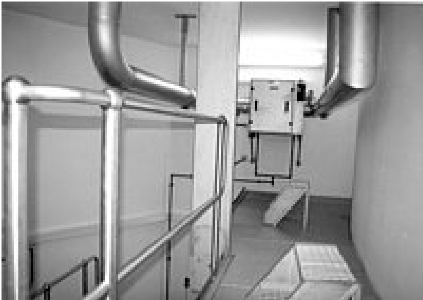
Luftfilteranlage im Trinkwasserspeicher für keimfreie Luft
