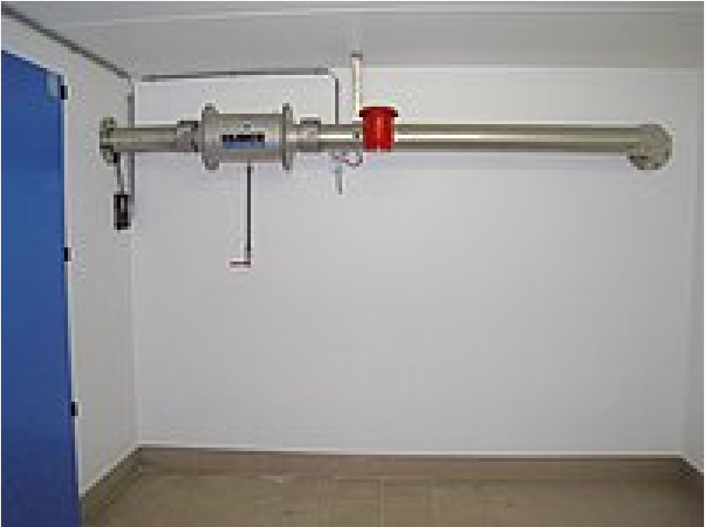
HUBER Luftfilteranlage L251 mit Rohreinschubventilator im HB Höhnhart, Oberösterreich
