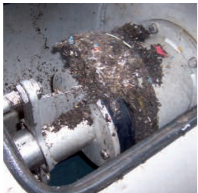
Austrag der entwässerten Störstoffe aus dem Fremdstoffabscheider
