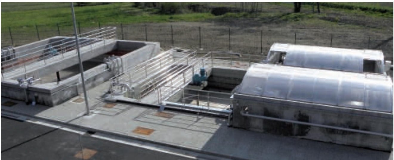
Misch- und Ausgleichsbecken, Biologiebecken und HUBER Membranbiologie
