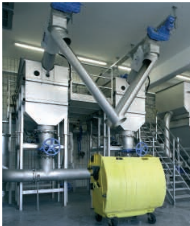
2 ROTAMAT® Siebanlagen Ro 2 neben der HUBER Flotationsanlage HDF
