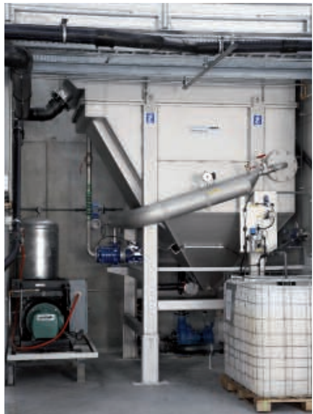
Prozesswasseraufbereitung mit HUBER Druckentspannungsflotation HDF
