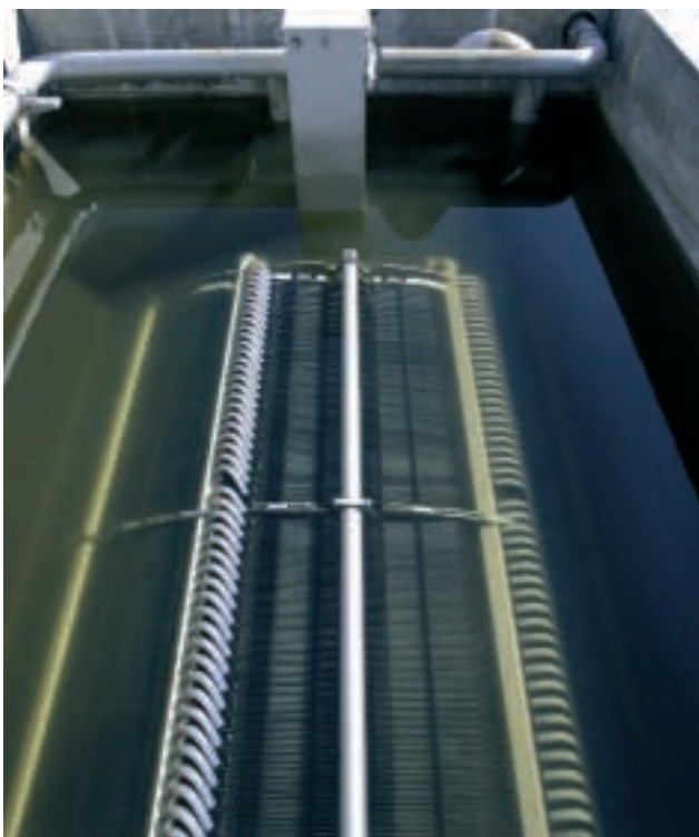
HUBER Membranbelebungsanlage VRM® während der Flutung
