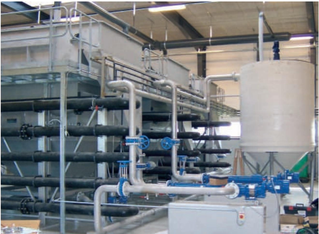
HUBER Flotationsanlage HDF 7 mit chemischer Stufe und Schlammbehälter
