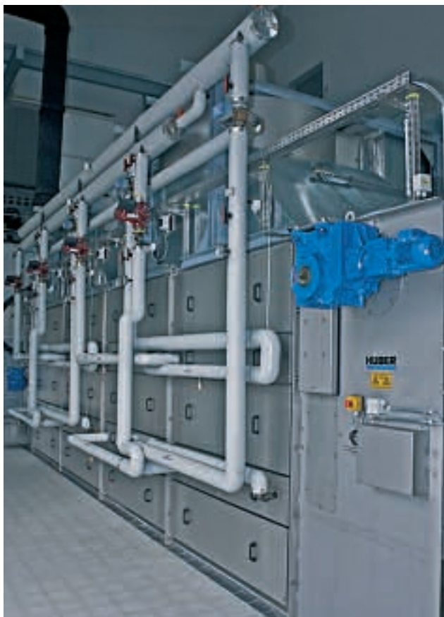
Wärmeversorgung eines Bandrockners durch Biogasabwärme
