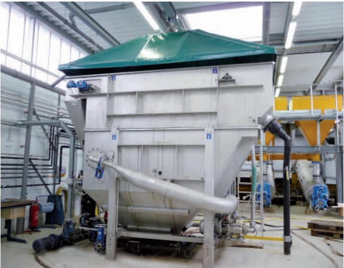
Presswasseraufbereitung mit HUBER Druckentspannungsfotation HDF
