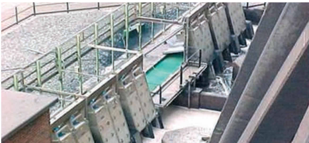
Je sieben HUBER STEP SCREEN® Vertical im Zulauf zum Kühlturm
