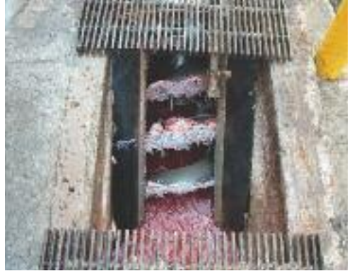
HUBER ROTAMAT® Filtrrococlea Ro9 con lamiera forata a 3 mm
