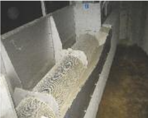
Misurazione di portata dello stramazzo con HUBER ROTAMAT® Griglia stramazzi RoK2
