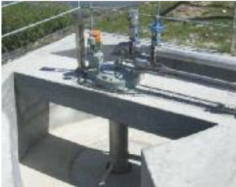
Vortex Separatore sabbie VORMAX prima dell'avviamento
