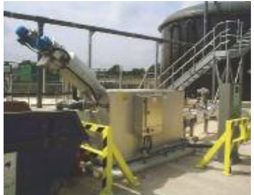
Installazione di ROTAMAT® Griglia fanghi Ro 3.1 all'aperto
