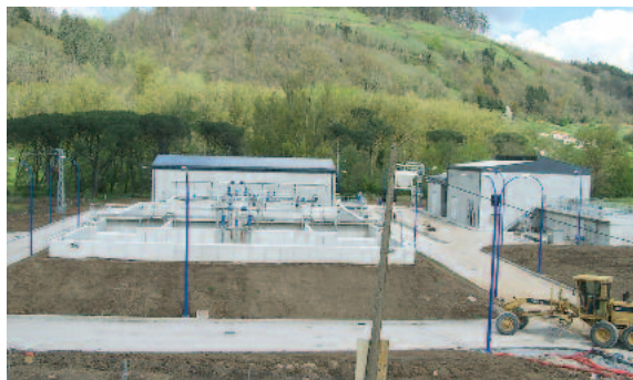
4 unités VRM® 30/448 installées sur la station d'épuration municipale de Arenas de Iguna (Espagne)
