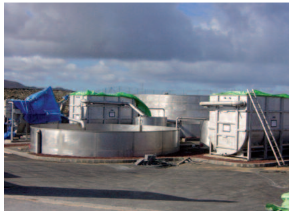
Deux VRM® 20/240 en caisson sur la station d'épuration municipale de la Santa (Iles Canaries)
