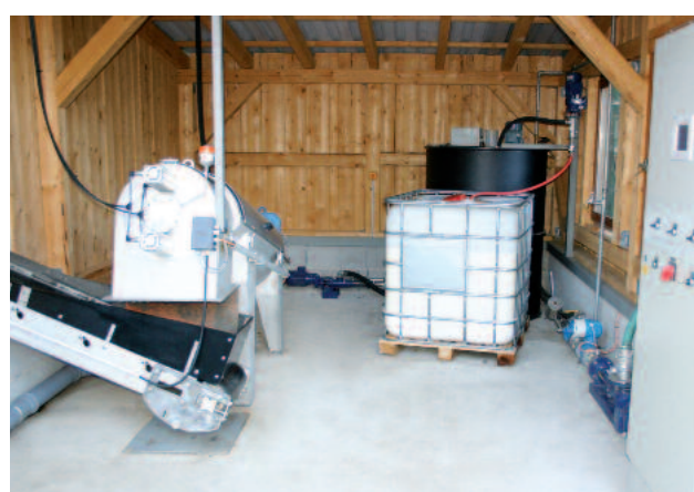
RoS 3Q 280 et périphériques installés dans 12 m²
