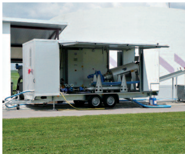
Unité mobile installée sur une remorque
