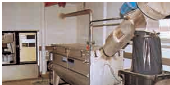
Dégrilleur Ro 3.1 avec ensacheur et échantillonneur.
