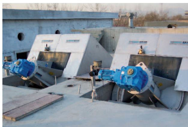
Installation im Freien mit Abdeckung und wärmegeämmter Siebgutleitung
