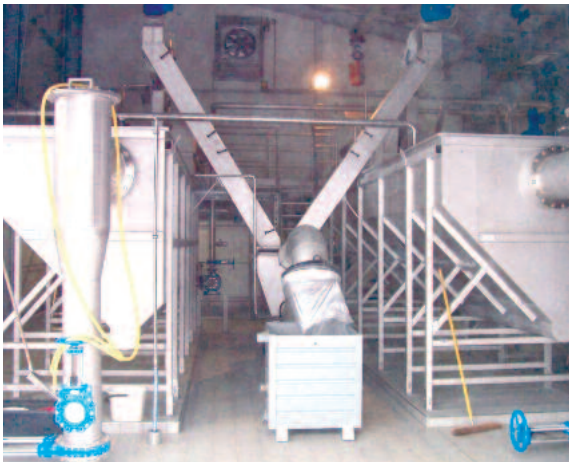
Deux installations Ro 5 avec presse laveuse WAP en complément
