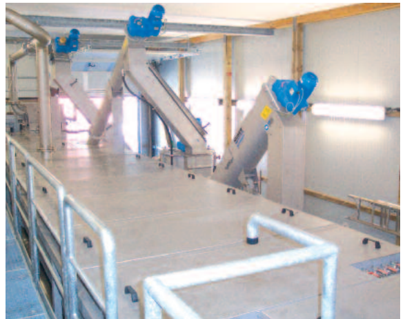
Extraction propre des dégrillés et du sable
