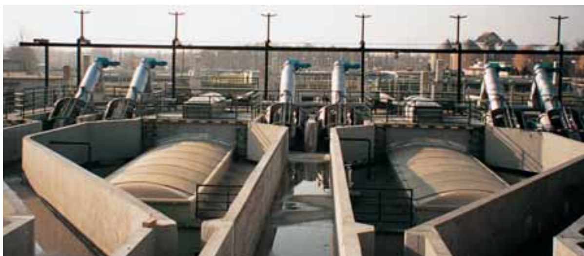
Station d'épuration de Budapest : 6 ROTAMAT® Ro 1, diamètre 2000 mm, entrefer 10 mm, Q_{max} = 6 \times 2500 \text{ m}^3/\text{h} , montés directement en canal et calorifugés.
